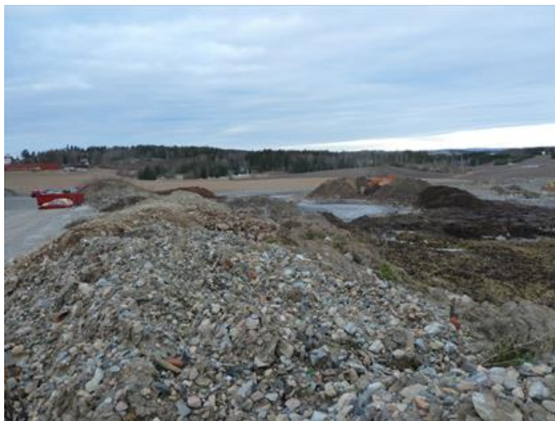
Figur 5 Bilde tatt mot nordvest. Sedimentasjonsdam ligger litt til høyre i bildet (Rambøll, 11/2-2016)
