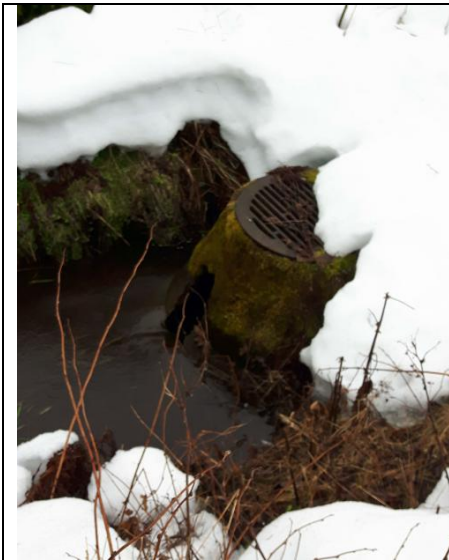
Figur 6: Overvannskum for innløp fra drenering på jordet og utløp for overvann fra Tamburbakken
