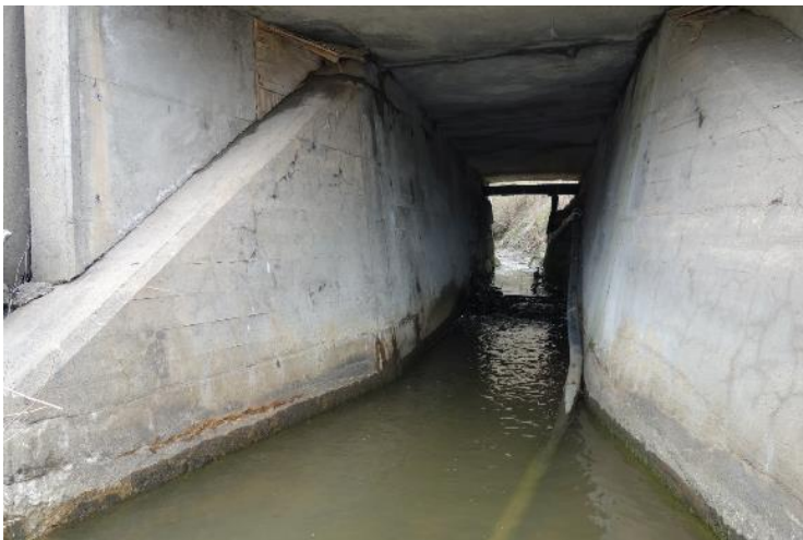
Figur 11: Romslig kulvert for flomvann og problemfri passering for anadrom fisk ved Kaksrubbekken sitt løp under Nettetveien.
