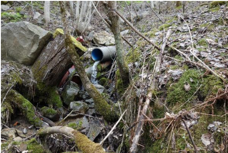
Figur 13: «Samløpet» med bekken fra planområdet og Kaksrubbekken. Røret var svært underdimensjonert til å ta unna større nedbørsmengder. Det er heller ingen mulighet for fiskevandring opp dette røret.
