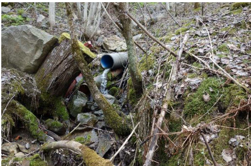
Figur 11. Utløpet til stikkrenne nr. 7 under Nedre Bekk vei, med utløp til Bekkelva. Gjengitt fra rapporten Naturmiljøvurderinger (Multiconsult, 2018b).
