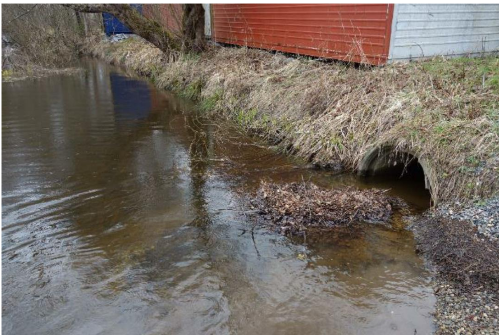
Figur 13. Antatt utløp av stikkrenne nr. 8 til Fålebekken. Gjengitt fra rapporten Naturmiljøvurderinger (Multiconsult, 2018b).
